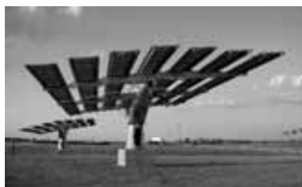
Paneles solares en Ataquines
